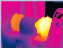
Laakerin suoja ylikuumentunut
